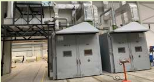
Obr. 3 Dopalovací jednotka s rekuperátorem tepla sloužící ke spalování odpadních emisí. Pomocí rekuperace se využívá odpadní teplo k opětovnému ohřevu polymerizačních pecí a současně i k vytápění části výrobní haly.
